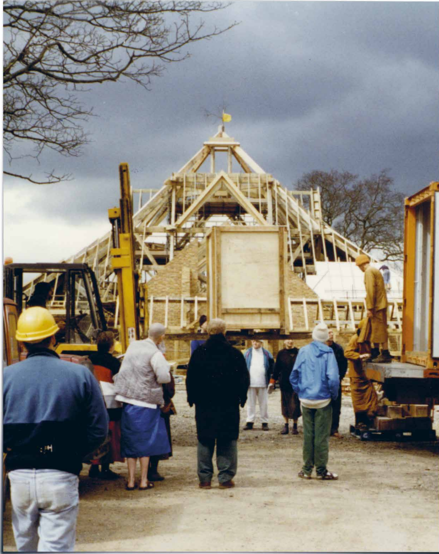
การประกอบโครงสร้างอุโบสถตากฟ้าใต้ ๑๕มิ.พ. ๒๕๓๗
